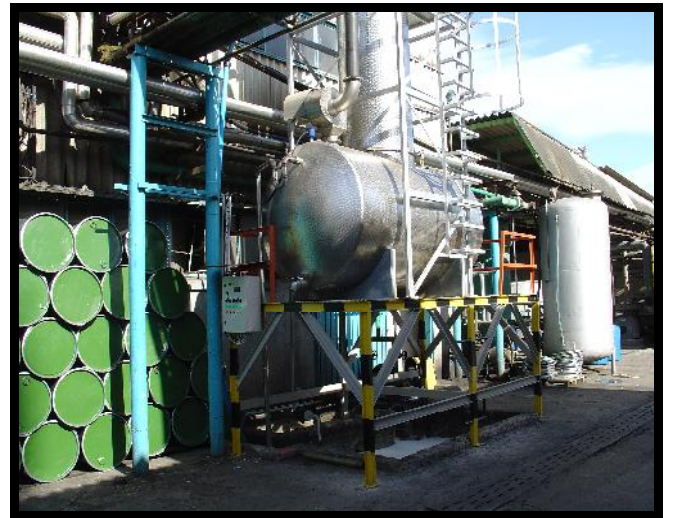
POLİSAN VOC WET SCRUBBER-GENEL GÖRÜNTÜ
