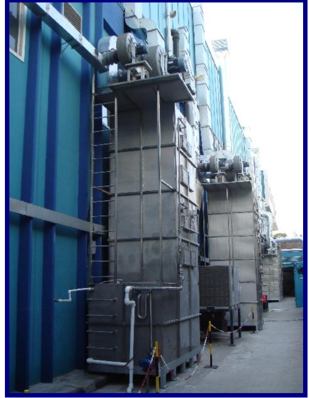
VOC WET SCRUBBER (SANDOZ İLAÇ)
