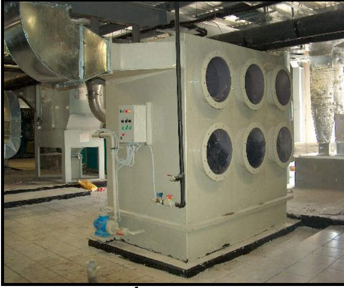
NOVARTIS İLAÇ –VOC WET SCRUBBER
