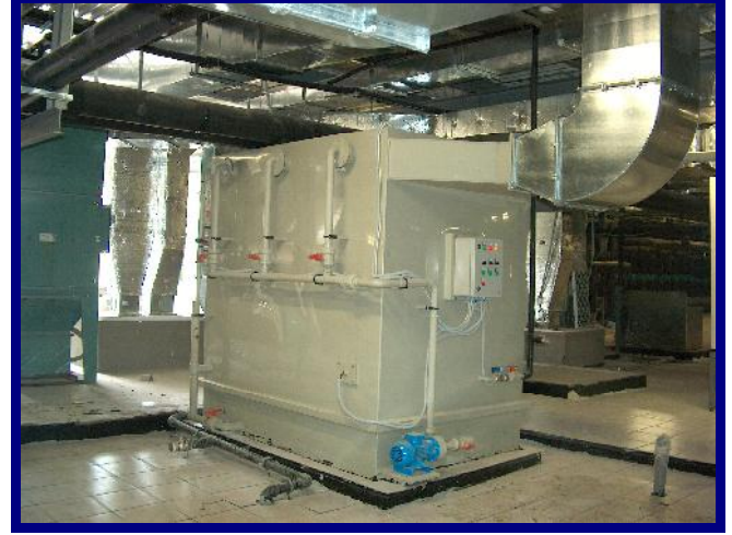
VOC WET SCRUBBER (NOVARTİS İLAÇ.)
