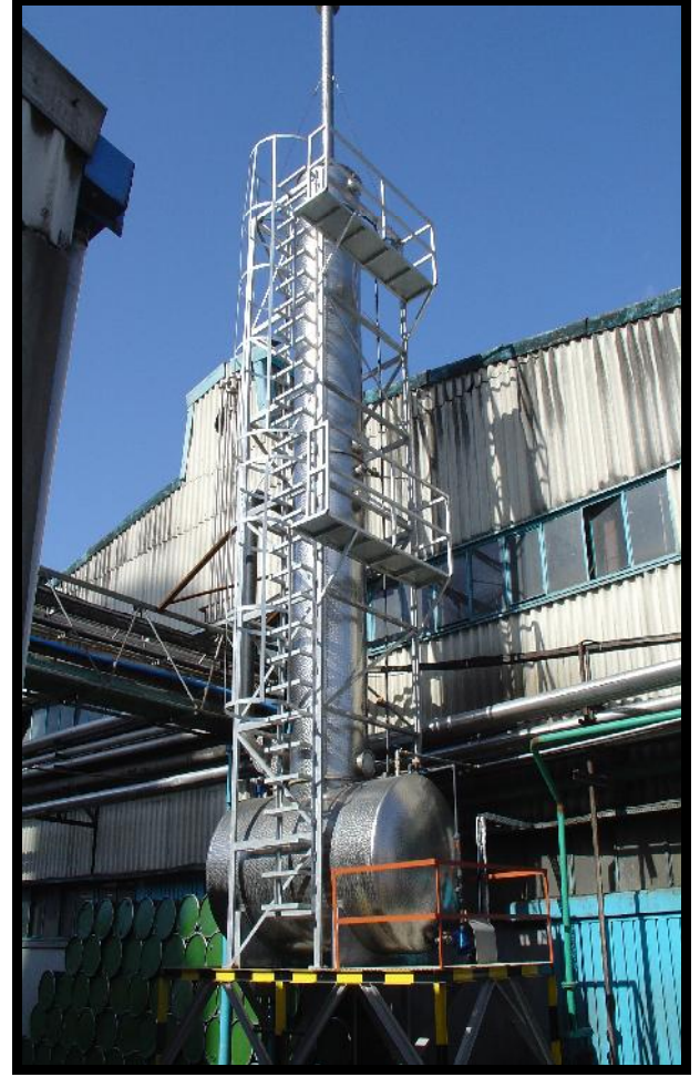
VOC WET SCRUBBER (POLİSAN BOYA)
