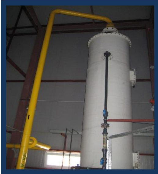
BİYOGAZ SCRUBBER GÖRÜNTÜ
