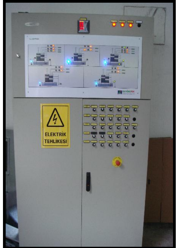
SANDOZ VOC WET SCRUBBER MCC PANOSU
