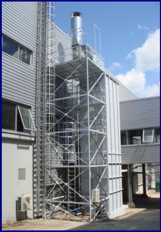
VOC WET SCRUBBER-GENEL GÖRÜNTÜ
