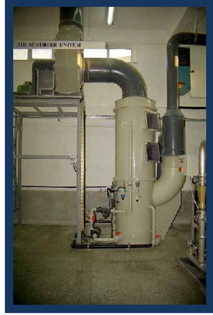
WET SCRUBBER (KAYSERİ 2.Hv K.K.)
