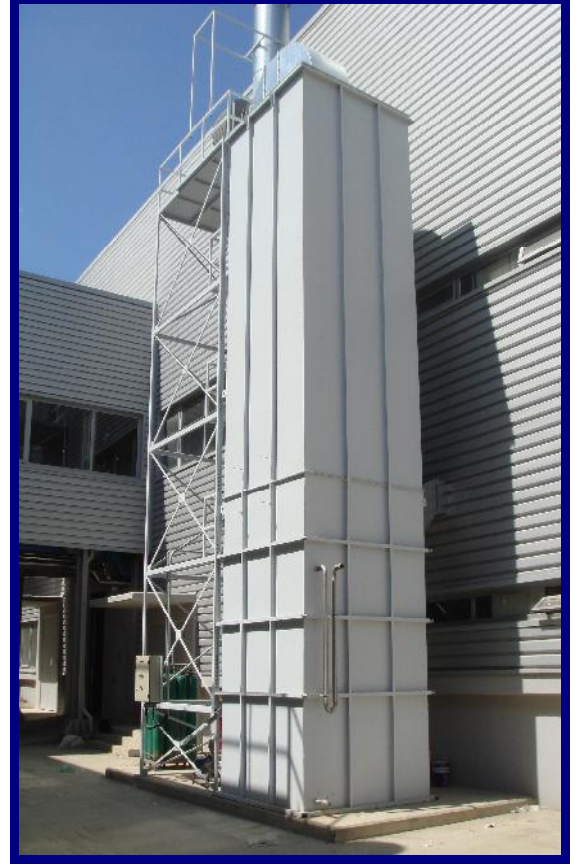
VOC WET SCRUBBER (KCC BOYA)
