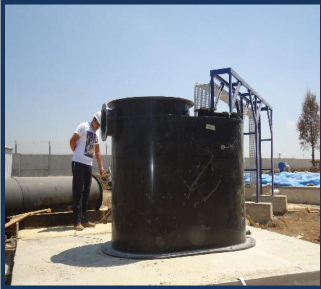
WET SCRUBBER GÖVDE VE ÇÖZELTİ DEPOSU
