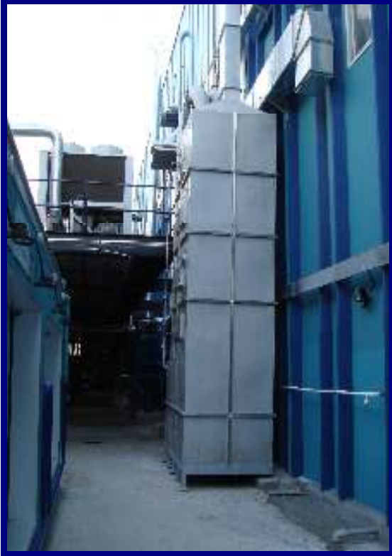
VOC WET SCRUBBER-GENEL GÖRÜNTÜ
