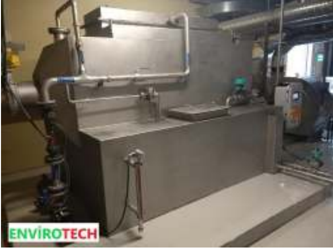
VOC WET SCRUBBER-GENEL GÖRÜNTÜ
