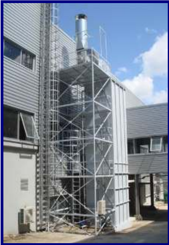
VOC WET SCRUBBER-GENEL GÖRÜNTÜ
