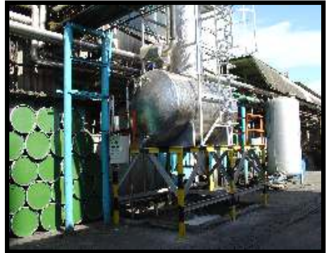
VOC WET SCRUBBER-GENEL GÖRÜNTÜ
