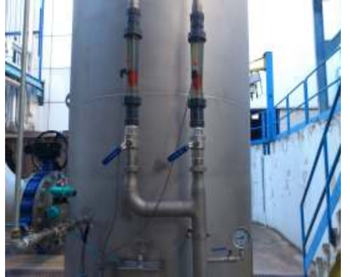
VOC WET SCRUBBER-GENEL GÖRÜNTÜ
