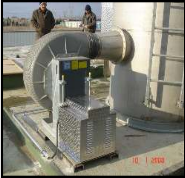
VOC WET SCRUBBER-GENEL GÖRÜNTÜ
