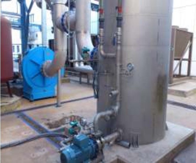
VOC WET SCRUBBER-GENEL GÖRÜNTÜ
