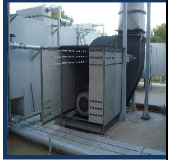
GİRİŞ YAPISI KOKU WET SCRUBBER
