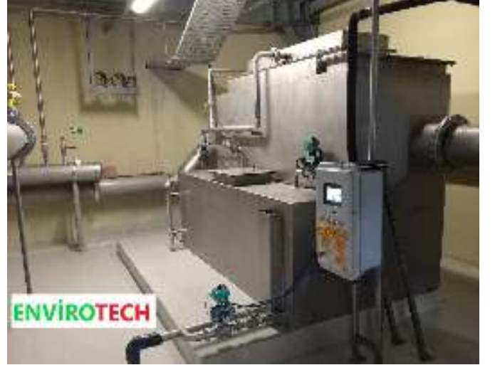
VOC WET SCRUBBER-GENEL GÖRÜNTÜ
