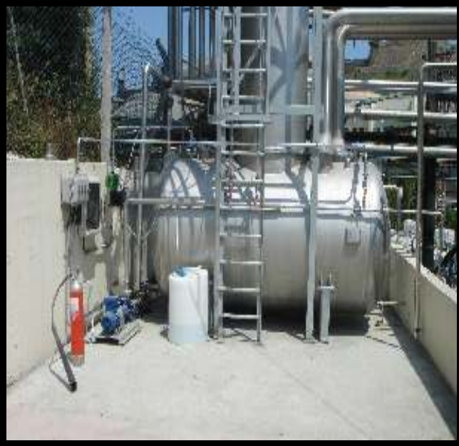
VOC WET SCRUBBER-GENEL GÖRÜNTÜ
