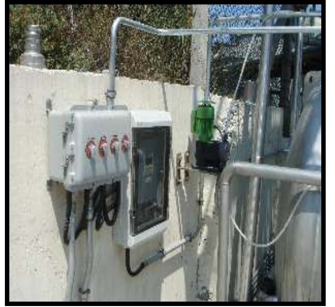
VOC WET SCRUBBER-GENEL GÖRÜNTÜ
