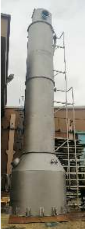
VOC WET SCRUBBER-GENEL GÖRÜNTÜ
