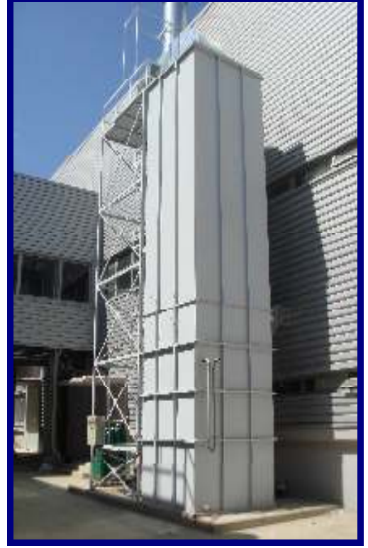
VOC WET SCRUBBER (KCC BOYA)
