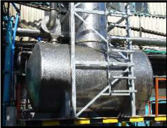
VOC WET SCRUBBER-GENEL GÖRÜNTÜ
